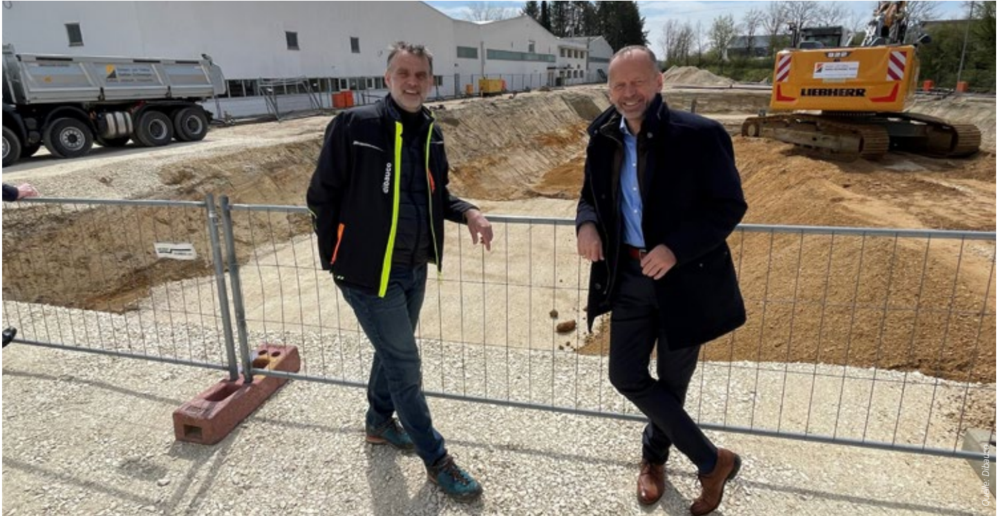
Tief unter der Erdoberfläche fängt die Arbeit für die von Michael Funke (rechts) geführte Dibauco an. Das war auch auf dem Gelände des Wärmepumpenherstellers Wolf in Mainburg (Landkreis Kelheim) so
